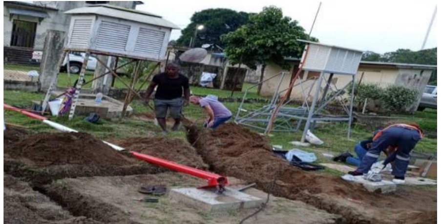
L'installation de la station météo d'Adiaké faite par les équipes du SETIM
