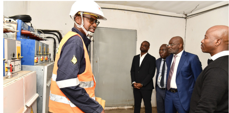
Un expert de la CIE explique les caractéristiques du poste aux responsables de l'aéroport et de CI Énergies
